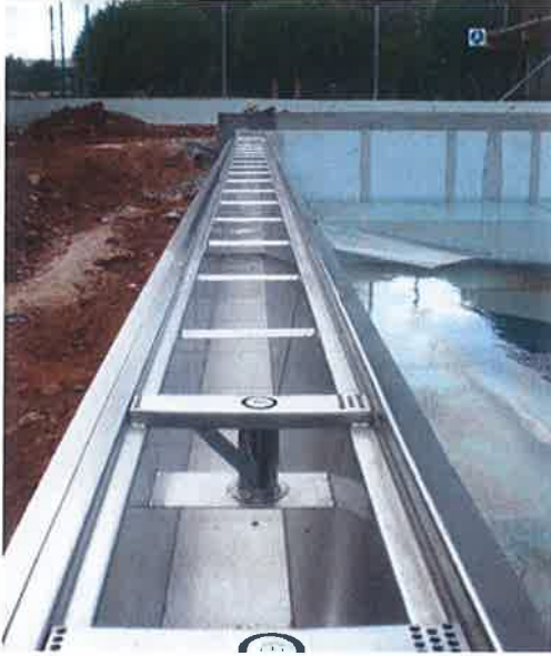
Goulotte de débordement et supports d'échelle
